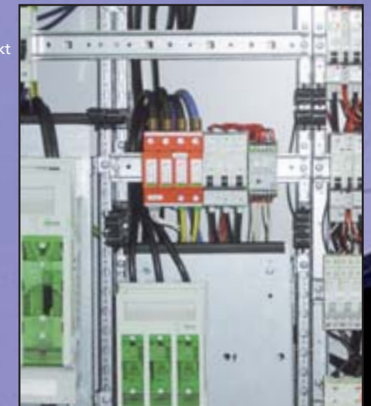
Einsatz DEHNguard® M TNS 275 FM im Schaltschrank/ Application DEHNguard® M TNS 275 FM in switchgear cabinet
